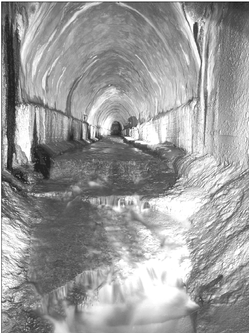
Рис. 2. Образование эвронзионного котла на стыке двух участков коллектора ручья Поклонной горы. Фото В.А. Неходцева
