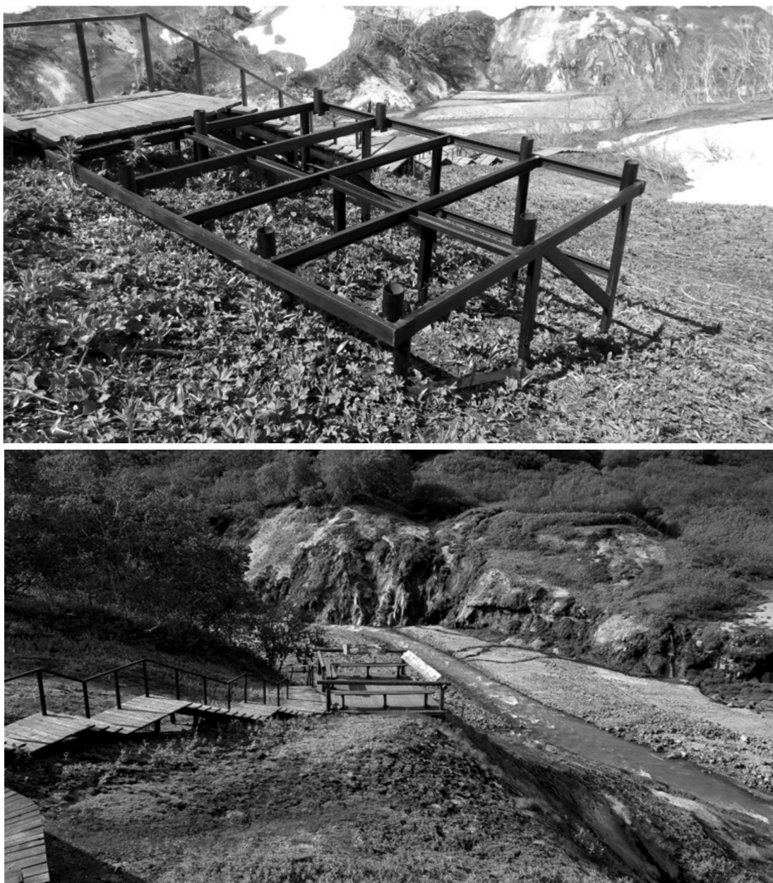
Рис. 2. Конструкция настильной тропы в Долине гейзеров после ремонта в 2014 г. Фото В.В. Непомнящего
